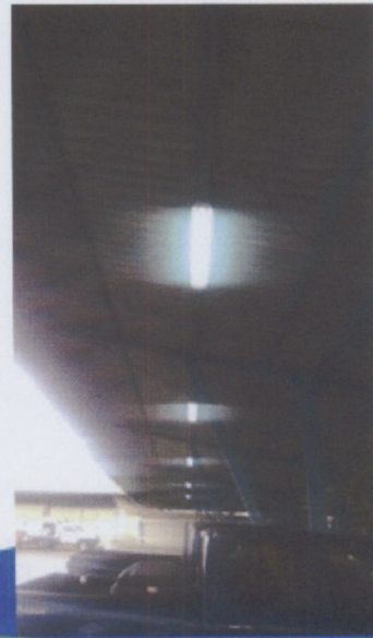
Figura N°9: sistema de iluminación del parqueo bajo techo.
