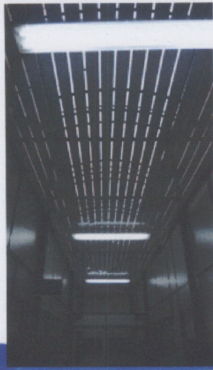
Figura N° 12: sistema de iluminación del pasillo edificio Administrativo
