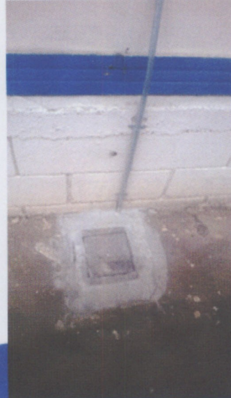
Figura N°7: Registro de puesta a tierra
