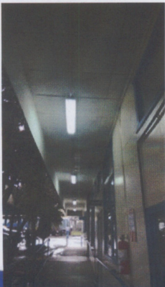
Figura N° 8: Sistema de iluminación de pasillo
