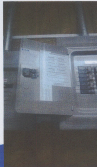
Figura N°11: Etiquetado de los centros de carga
