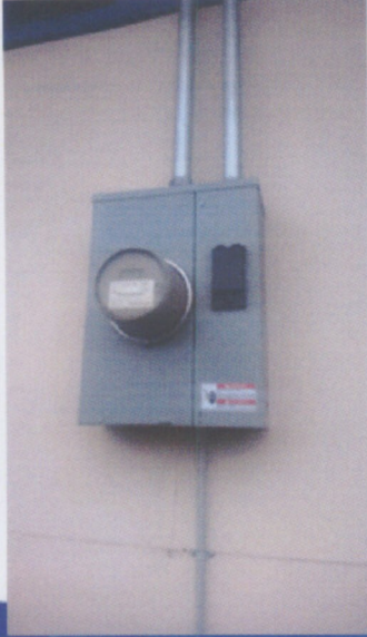
Figura N° 6: base de medidor de edificio Administrativo Fátima
