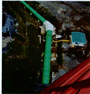
TUBERÍA DE PRESIÓN
