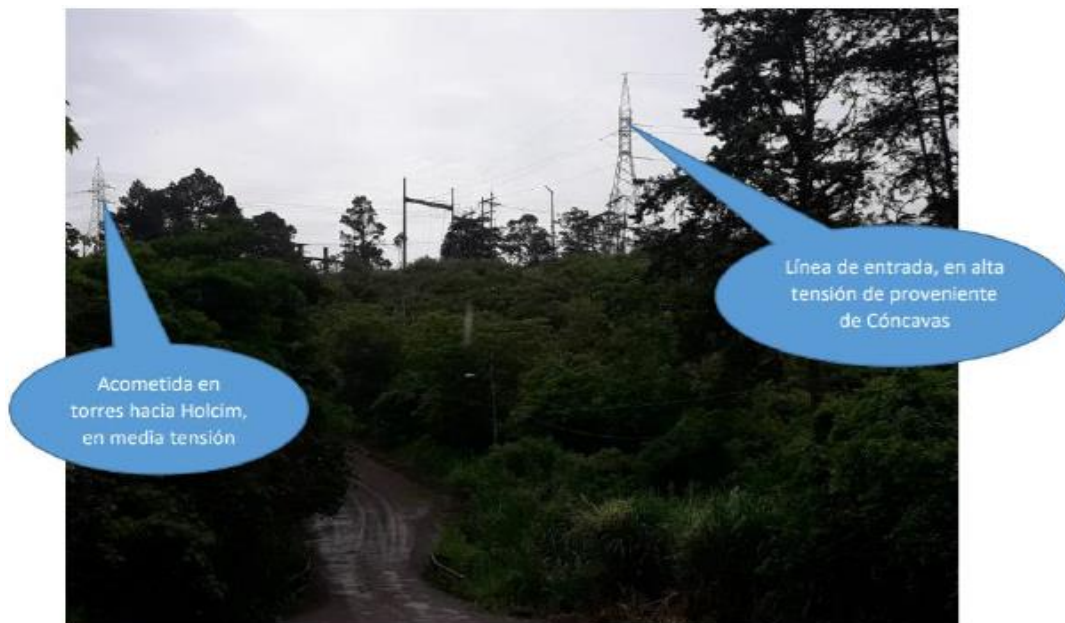
Imagen 2: Circuito de entrada en alta tensión y salida en media tensión hacia la planta de cemento
